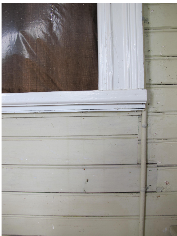
Bild. Lagning i vägghpanel under fönster som visar de tidigare fönstrens utbredning. Fönsterfoder av sen 1800-tals typ.
