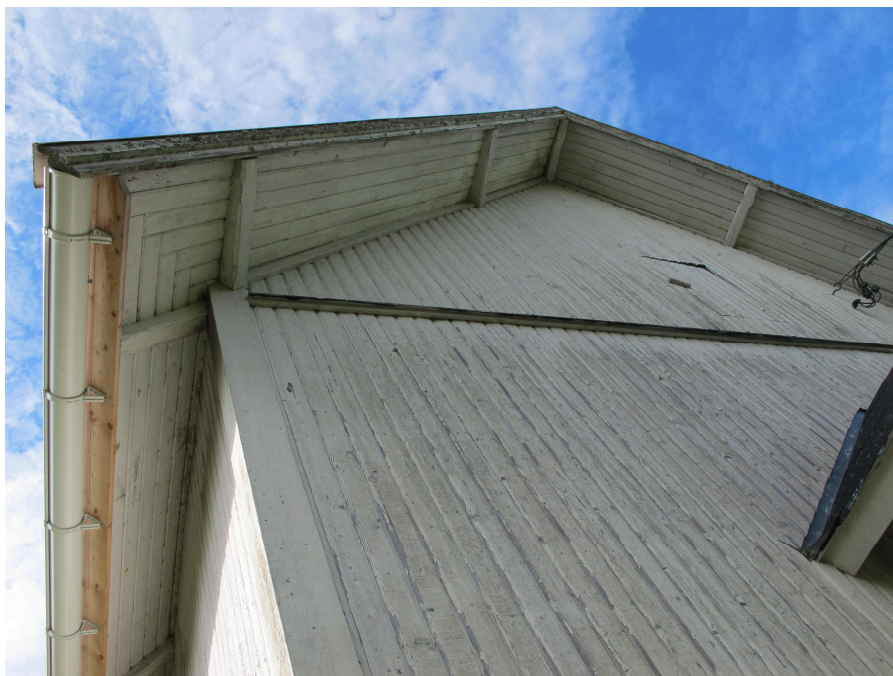
Bild. Östra fasaden med nedsmutsad delvis flagande fasad. Vindskivorna är mörka av någon påväxt. Till vänster syns den nya hängrännan som är monterad på ny ej innmålad bräda.
