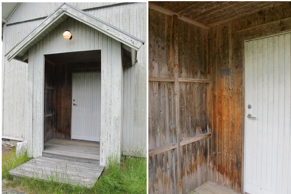
Bild. Det moderna vindsyddet framför entrén kan anpassas till helheten genom att målas även invändigt. Ytterdörren är av förrådstyp är inte vad som kan förväntas i en byggnad av denna karaktär. Den bör bytas mot en mer anpassad variant på sikt.
