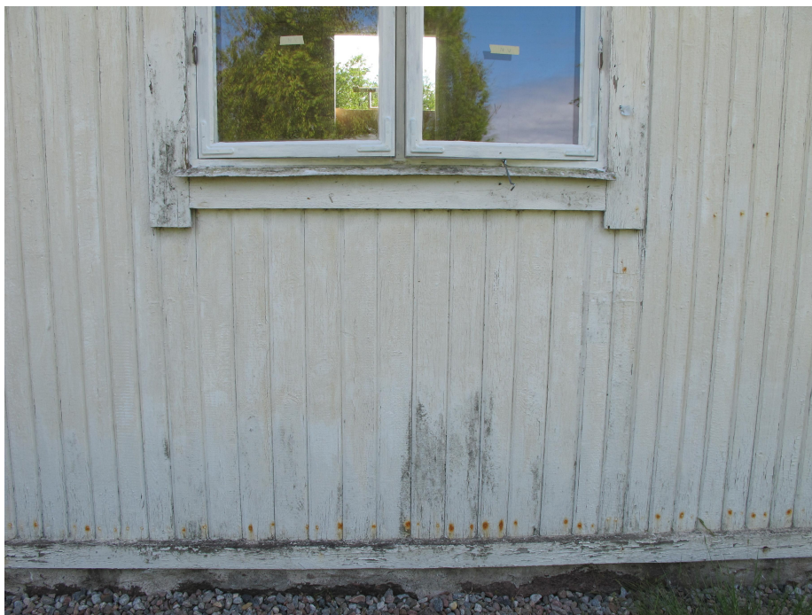
Bild: Fasadpanelen nedan fönstren är bredare lokalt, troligtvis till följd av fönsterbytet. De breda panelbrädorna är dock ramsågade precis som fasadernas äldre panelytor.
