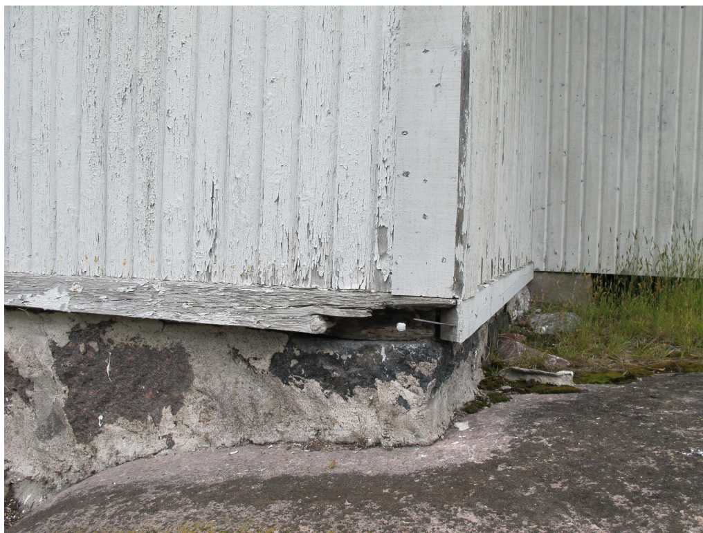
Bild. Vägghörn i sydöst med delvis bortfallen vattbräda och rötskadad syll.
